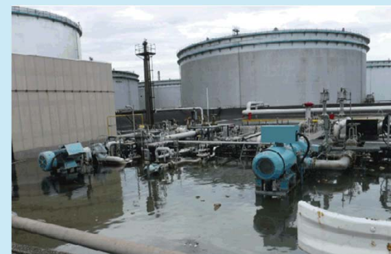
（製油所で発生した冠水被害）
